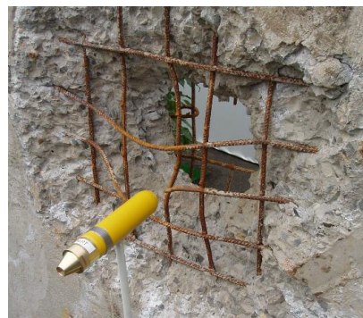
Рис. 2.2. Разрушение железобетонной плиты многоцелевым снарядом 40-мм пушки СТWS 40
